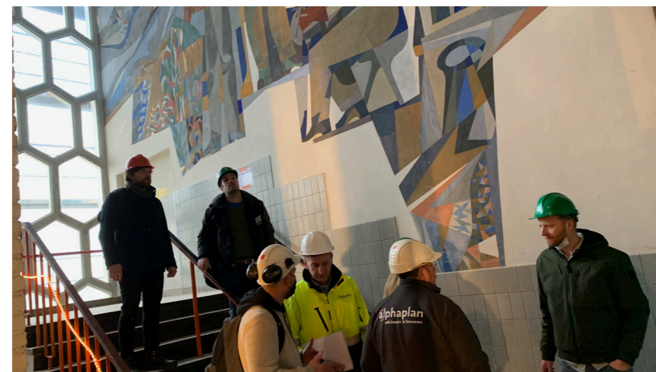
Februari 2022: Met Monumentenzorg Den Haag, de uitvoerders en de bouwinspecteurs op locatie om tijdens de voorzichtige start van de sloop de ontwerpuitgangspunten en bouwkundige ingrepen gezamenlijk vast te stellen.
