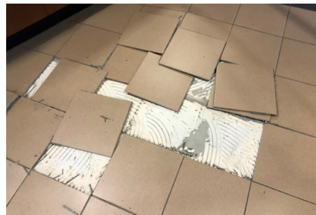
Problematiek bestaande vloer
